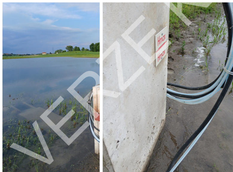
VÝPUSTNÉ ZAŘÍZENÍ VODNÍ NÁDRŽE A STAV VODY NA KONCI KVĚTNA 2024 (75 CM POD H max)
